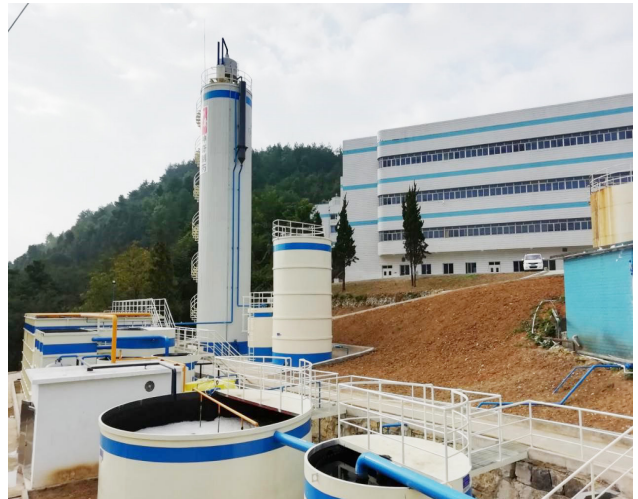
新建污水处理系统
